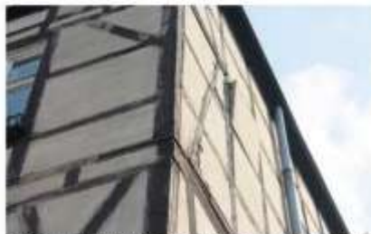
Zaniedbany budynek znajduje się dziś w katastrofalnym stanie. Dla porównania, na zdjęciu obok: tak prezentowała się jego klatka schodowa na początku XX wieku
